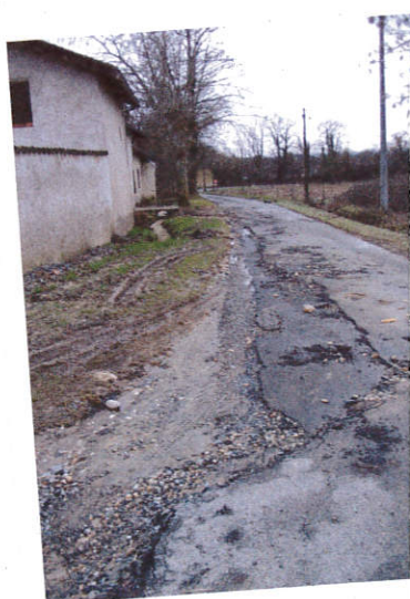
Chaussée arrachée suite à la crue du Râche (Genouilleux)
